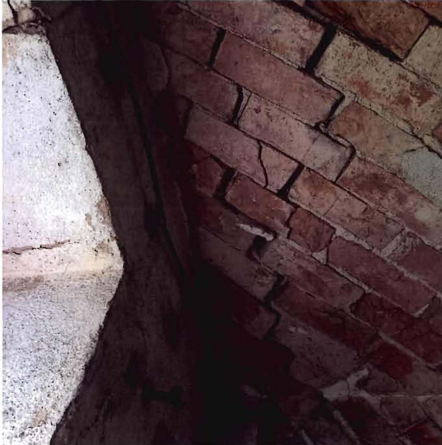
Fot. nr 4 – widoczne uszkodzenia sklepienia ceglanego
