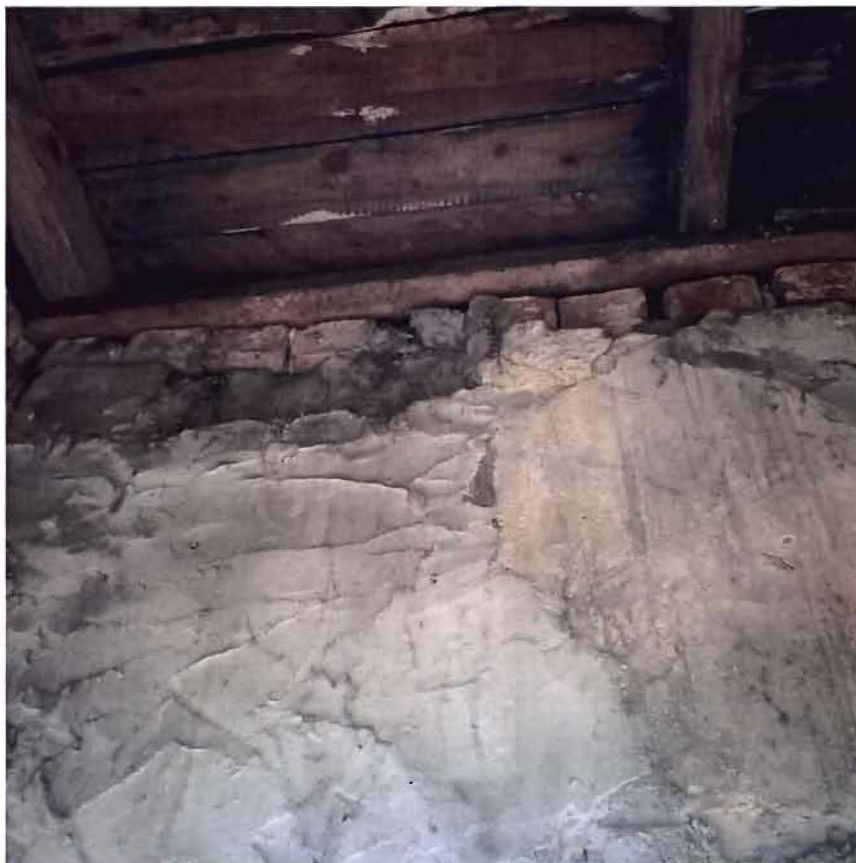
Fot. nr 2 – widoczne miejscowe ubytki ścian konstrukcyjnych
