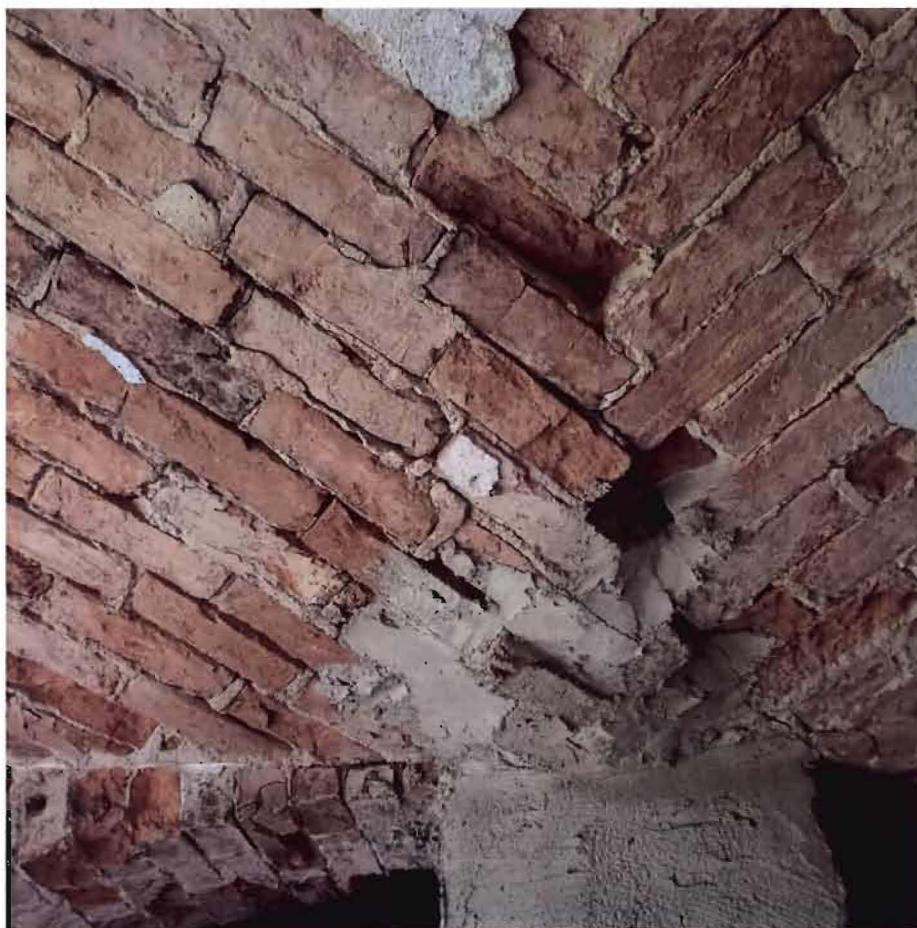
Fot. nr 3 – widoczne uszkodzenia sklepienia ceglanego
