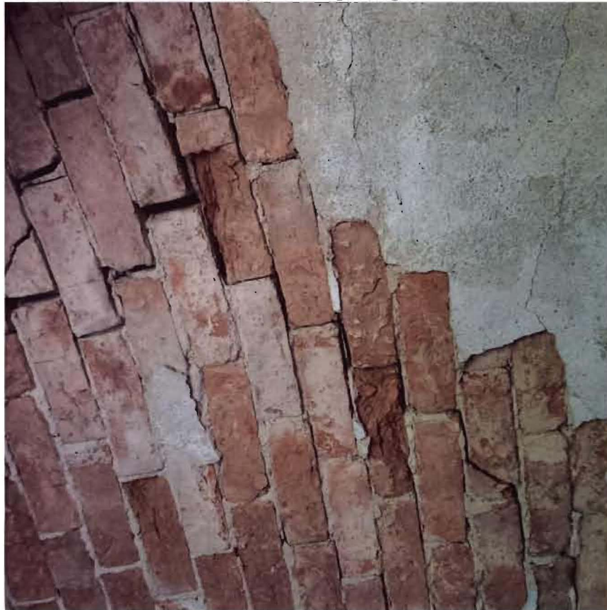
Fot. nr 5 – widoczne uszkodzenia sklepienia ceglanego
