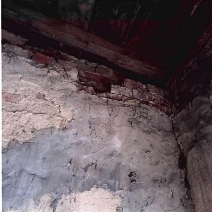
Fot. nr 1 – widoczne miejscowe ubytki ścian konstrukcyjnych
