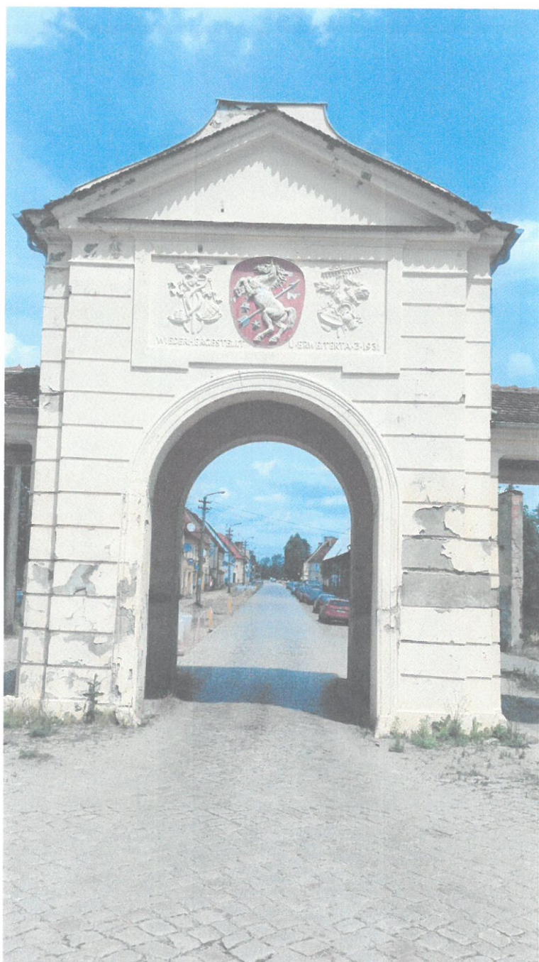
Fot. 3 Widok elewacji południowej – widoczne złuszczenia farby oraz ubytki tynku.
