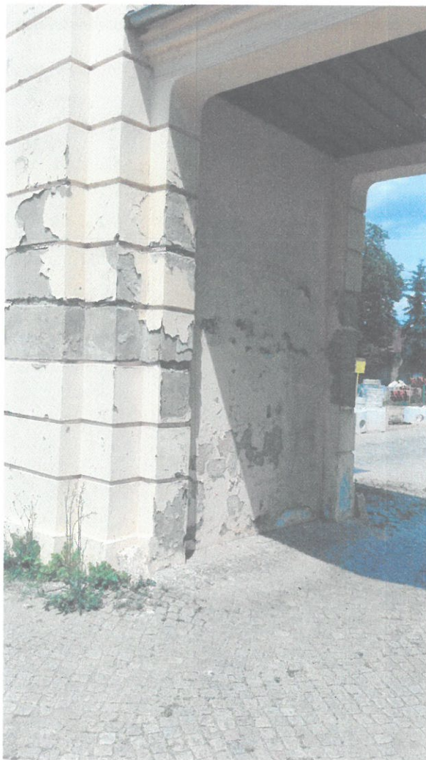
Fot. 5 Widok elewacji południowej – widoczne złuszczenia farby oraz ubytki tynku.
