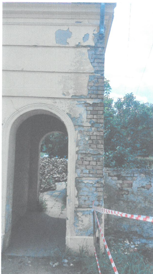
Fot. 6 Widok elewacji północnej – widoczne złuszczenia farby oraz ubytki tynku.
