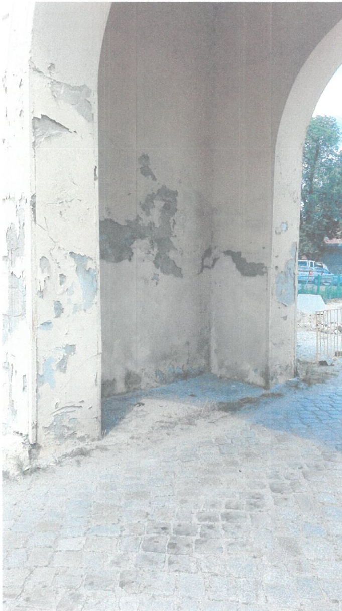
Fot. 11 Widoczne złuszczenia farby oraz ubytki tynku.
