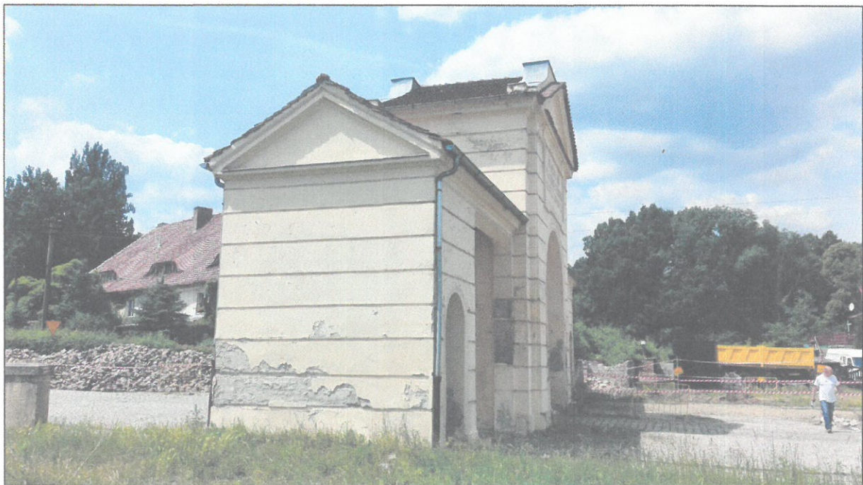
Fot. 2 Widok elewacji wschodniej – widoczne złuszczenia farby oraz ubytki tynku.
