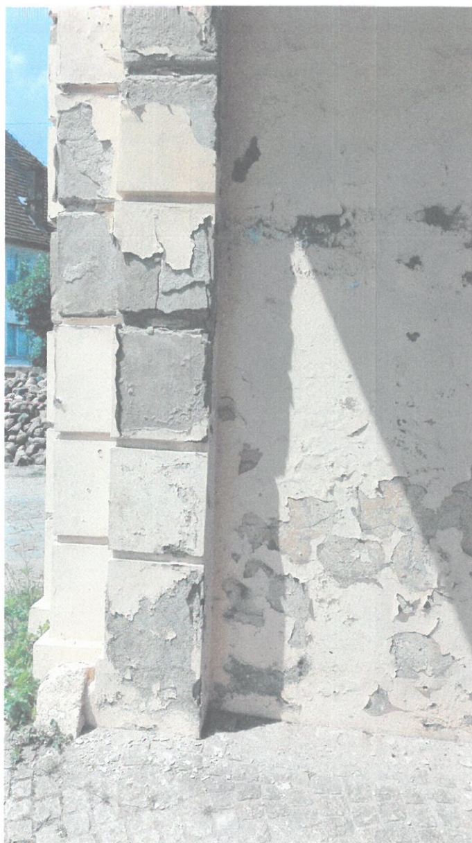
Fot. 8 Widok elewacji południowej – widoczne złuszczenia farby oraz ubytki tynku.
