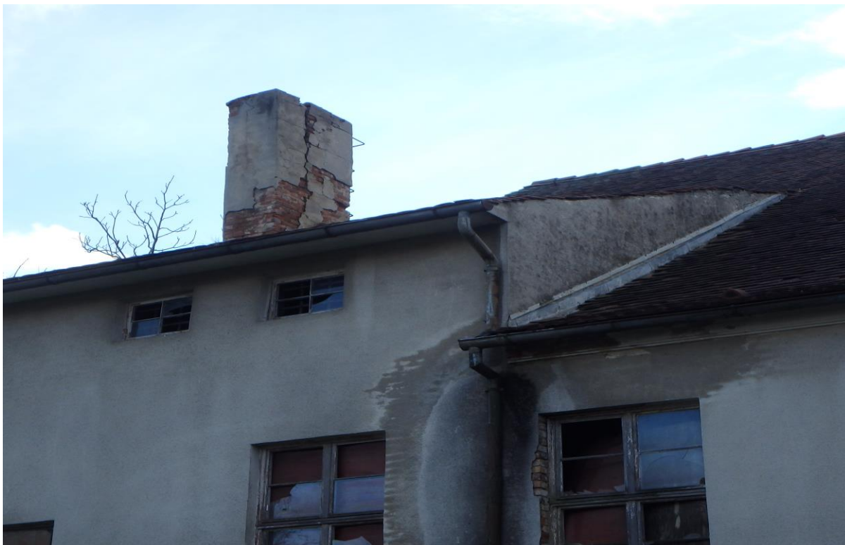
Zdjęcie nr 5 - Widok na elewację frontową budynku (zacieki na elewacji, ubytki w tynku oraz widok na komin)
