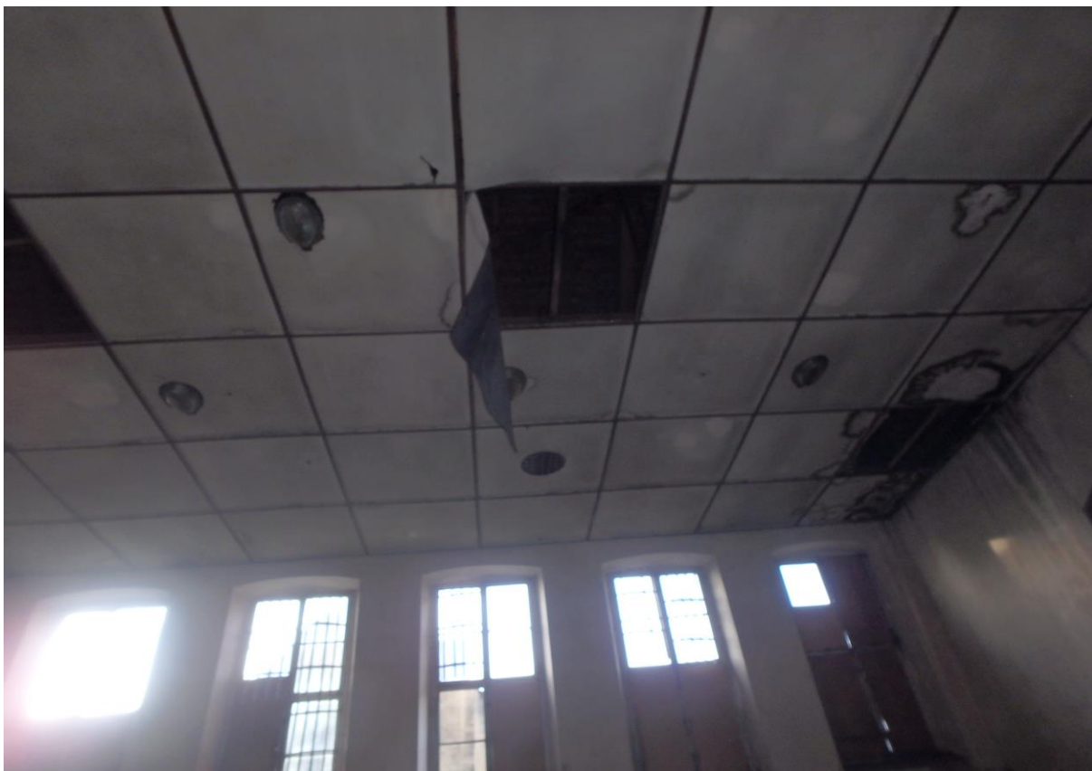
Zdjęcie nr 49 - Sufit pomieszczenia na piętrze budynku
