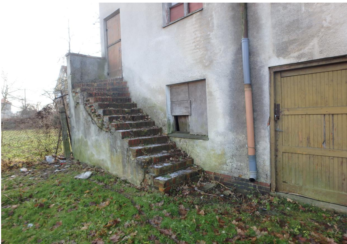
Zdjęcie nr 6 - Widok na elewację frontową budynku (zacieki na elewacji, ubytki w schodach)
