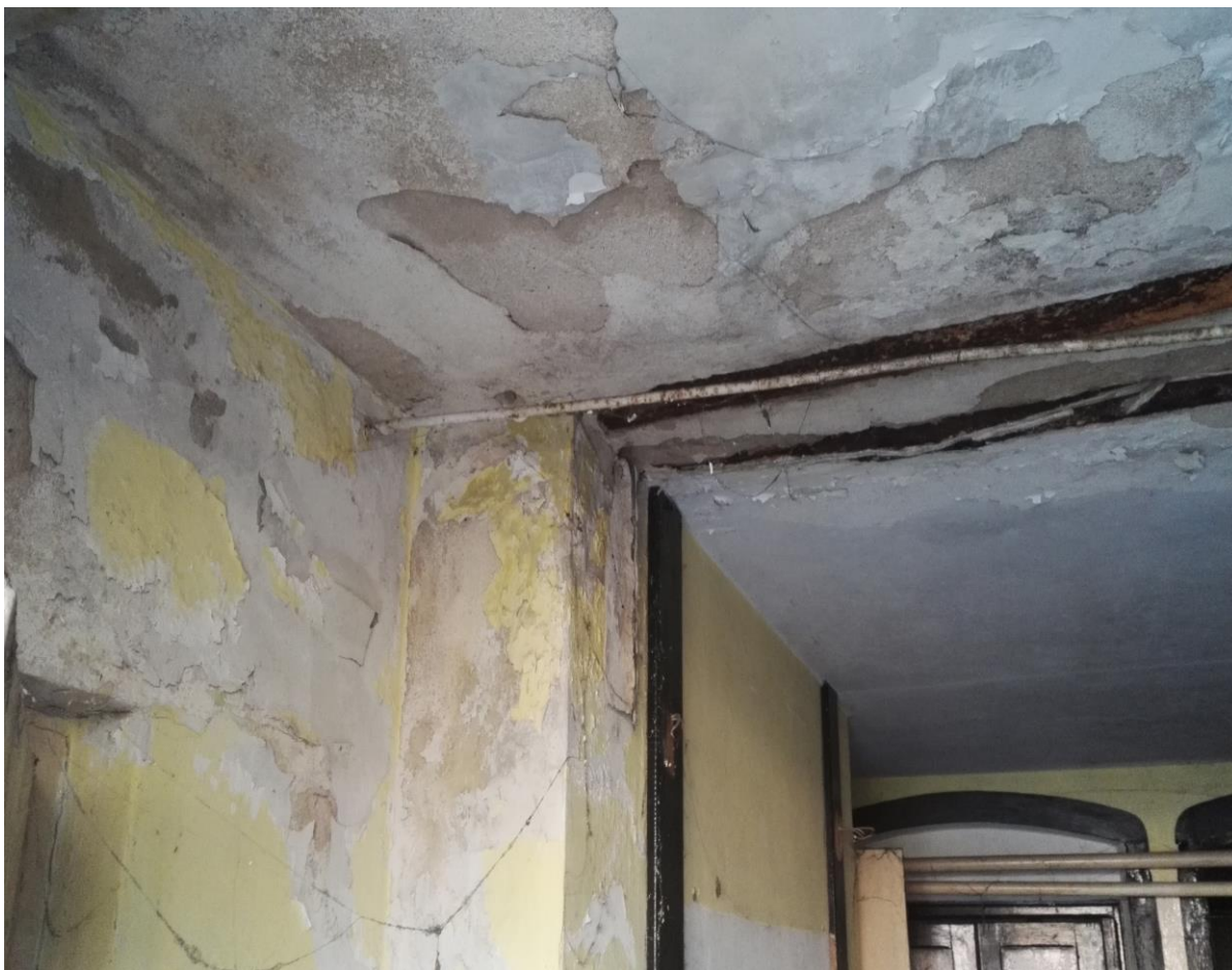
Zdjęcie nr 11 - Sufit w pomieszczeniu na parterze budynku
