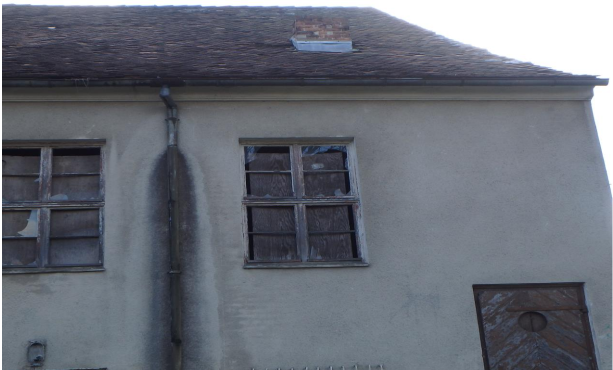
Zdjęcie nr 4 - Widok na elewację frontową budynku (zacieki na elewacji)
