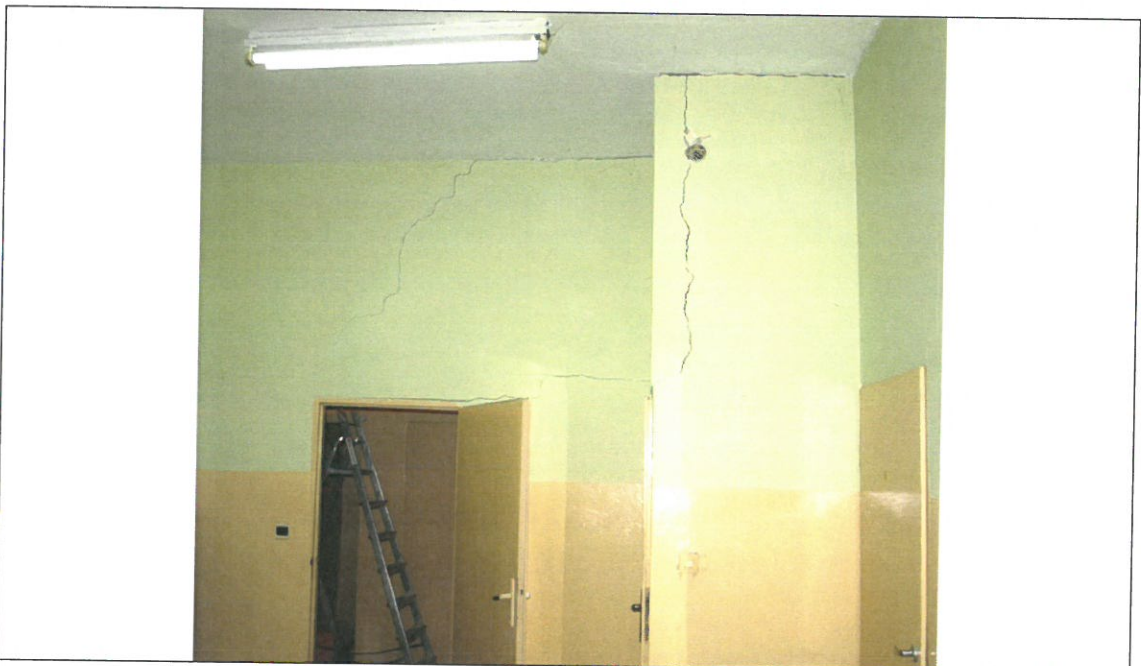
Fot. 2 Uszkodzenia ścianek działowych
