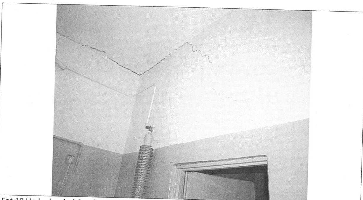
Fot.10 Uszkodzenie ścianek działowych pomiędzy pom. nr 11 a pom. 2 i 10 (widok z pom. 11)
