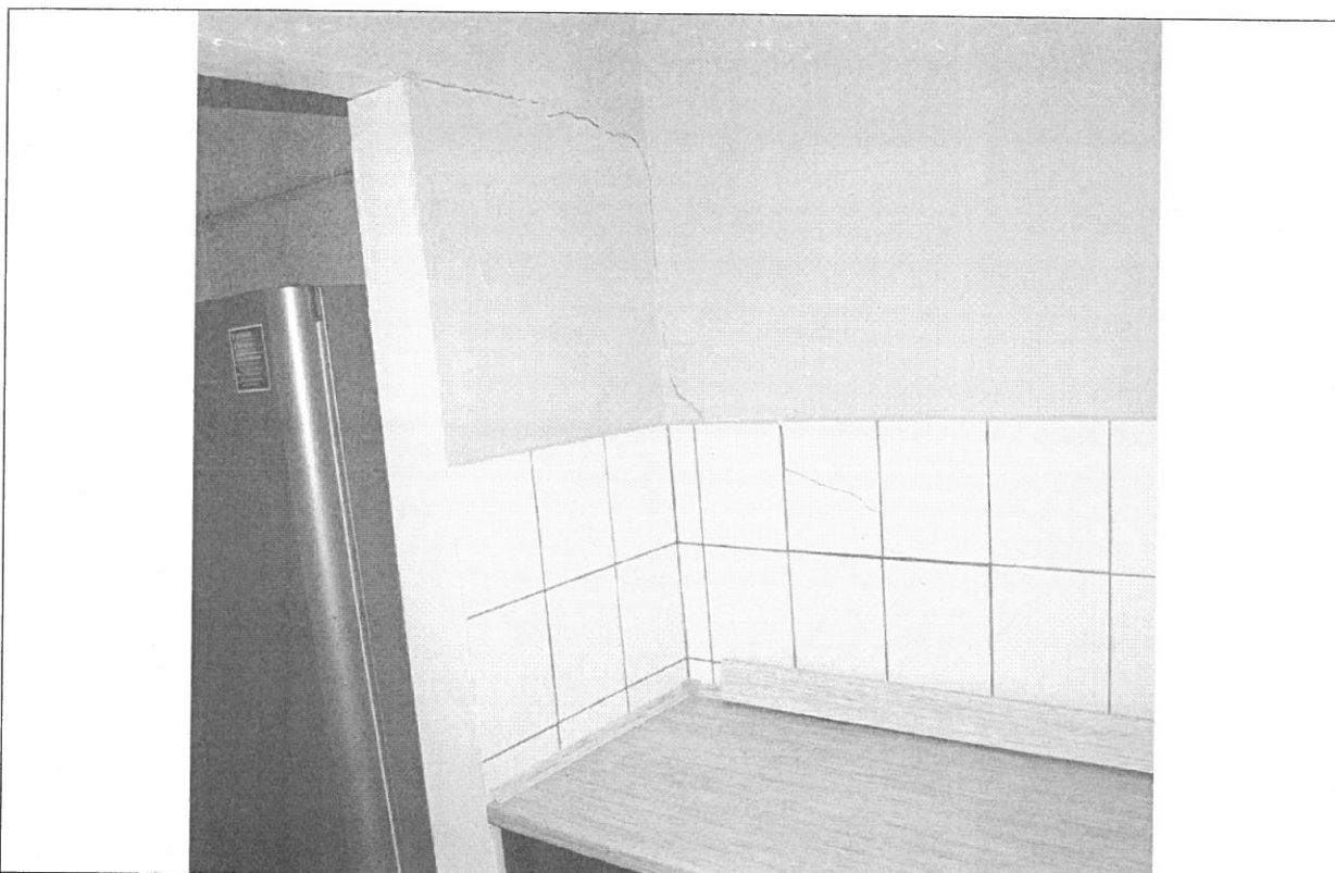
Fot.7 Uszkodzenie ścianek działowych pomiędzy pom. nr 8 a pom. nr 9 i 12 (widok z pom. 8)
