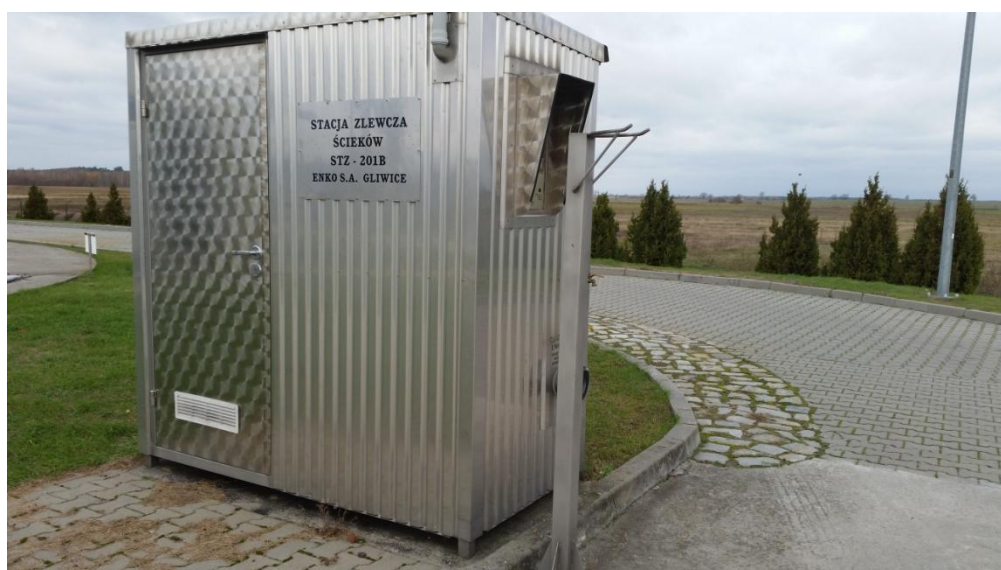
Rysunek 19. Widok na stację zlewczą ścieków dowożonych taborem asenizacyjnym
